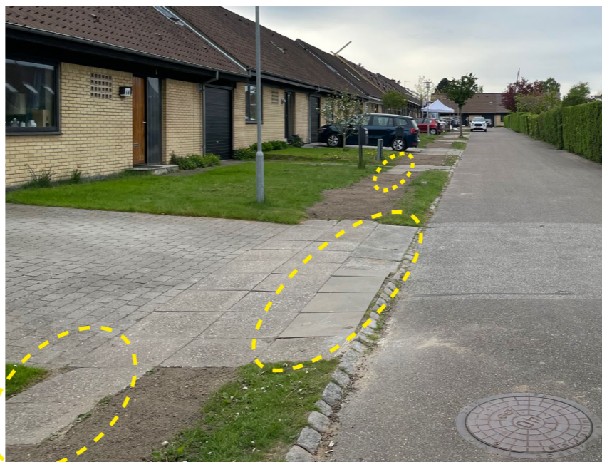
Upræcise overgange til postkasser. Ujævn belægning, eksist. fliser ikke lagt om.
