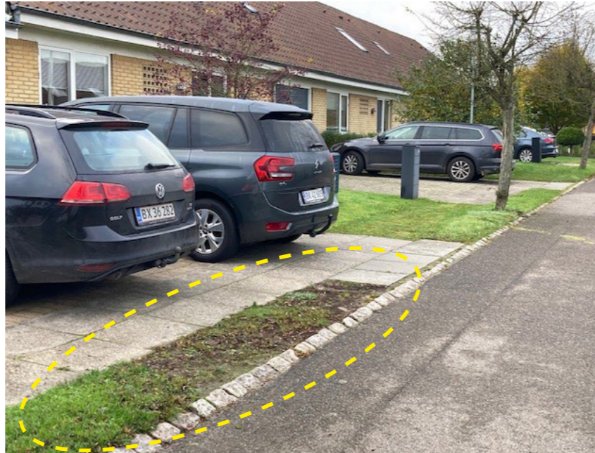
Manglende overgang ml. indkørsel og vej.
